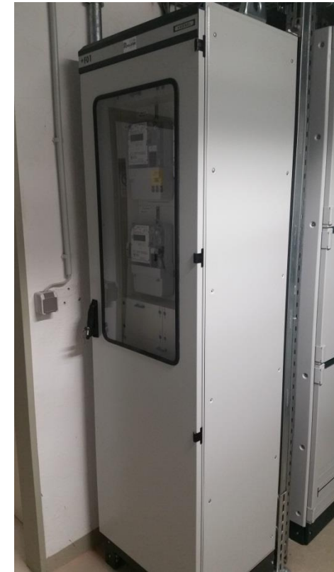
Abb. 7 Zählerschrank mit Glastür
