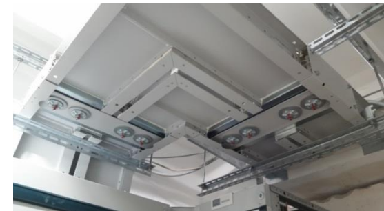
Abb. 4 Stromschienensystem Sivacon 8PS
