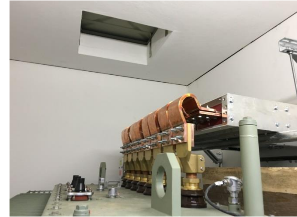
Abb. 3 Flexible Kupferbänder zum Anschluss des Transformators an das Stromschienensystem
